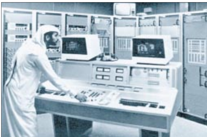
Zentraler Kontrollraum von QBS Doha
